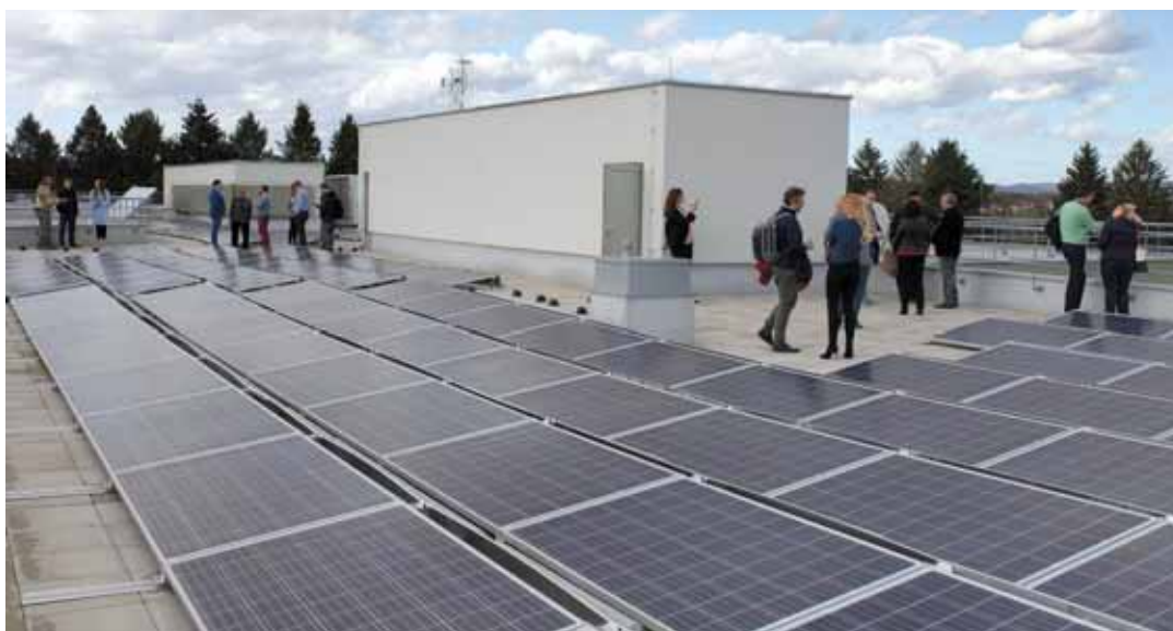
Slika 8 – Solarna elektrana 35 kW u Križevcima(Hrvatska) finansirana u potpunosti sredstvima građana
